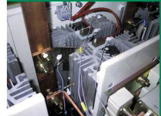
Type test of the rectifier
